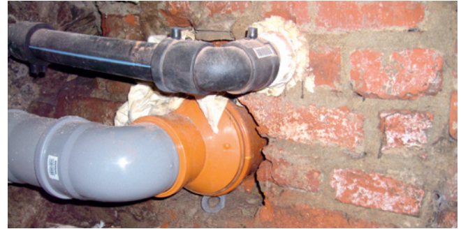
Radoneintrittspfade an unzureichend abgedichteten Leitungsdurchführungen
